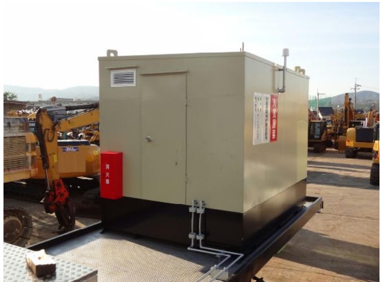
②トレーラー上 油庫
